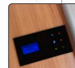
Panneau de commande et de contrôle électrique Electrical control panel
